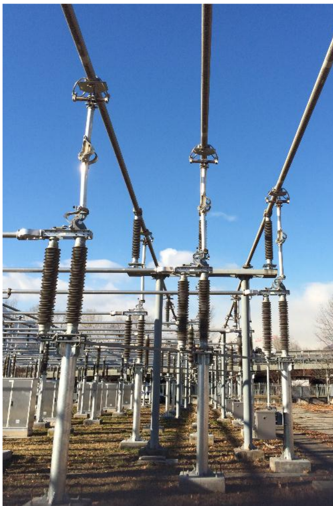
Sectionneur SPVL avec commande DWatch installée
