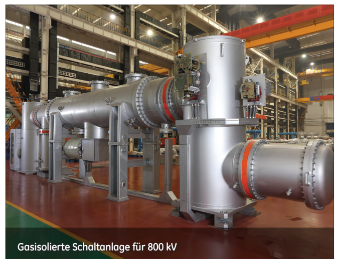
Gasisolierte Schaltanlage für 800 kV in der Verteilerstation Lan Zhou
