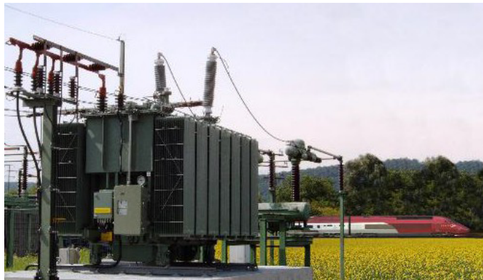
Transformador para trilhos de 15 MVA 120/17,25 kV 16,7 Hz
